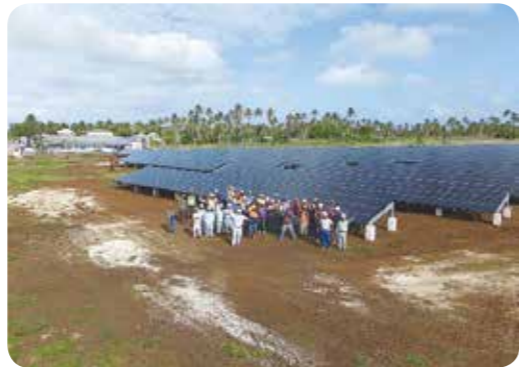
太陽光発電設備
